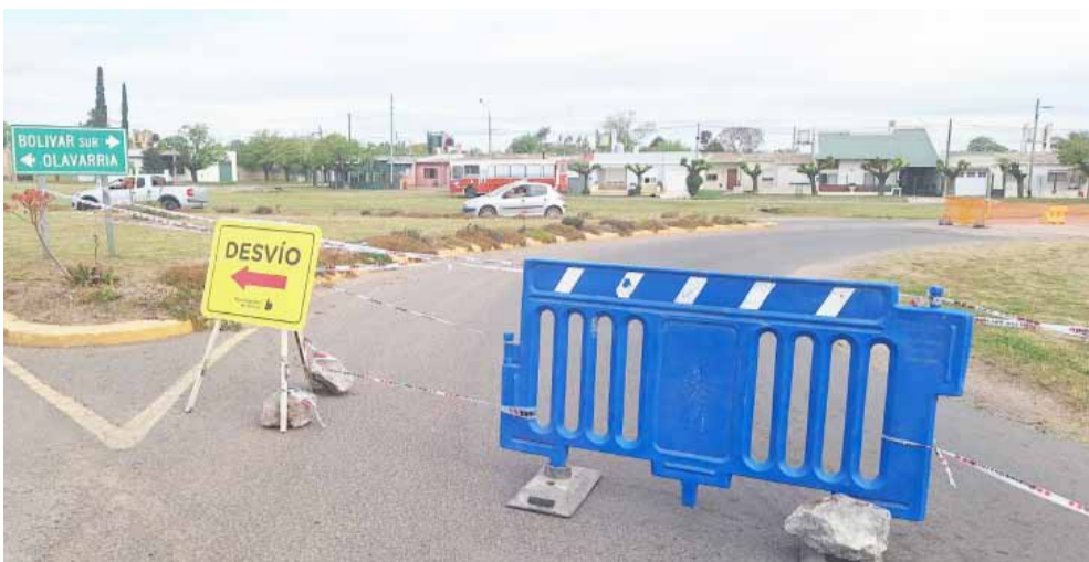
El tradicional ingreso a la Calfucurá pasando la rotonda está cerrado.
